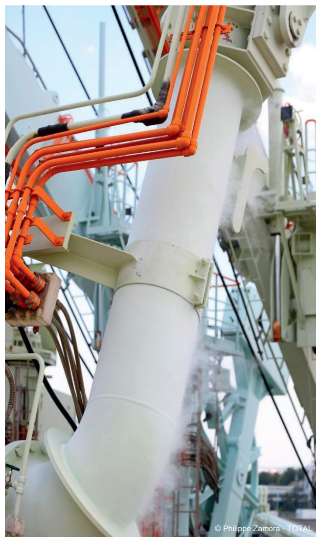
Pipe on the Arwa Spirit LNG Tanker
